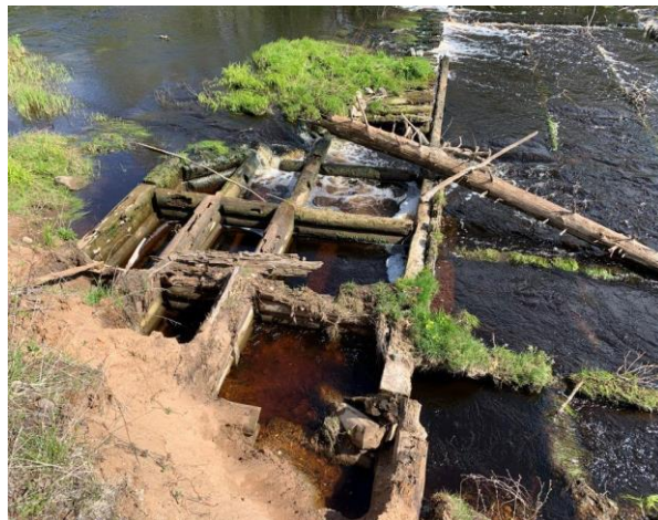
Рисунок 3.5.2. Разрушенный шлюз, р. Соминка - д. Лопастино
